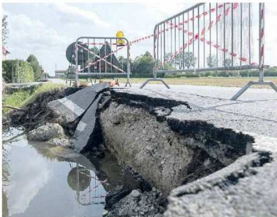
VORAGINE L'albero caduto in via Don Orione a Mirano ha "strappato" una fetta di asfalto, creando una voragine in strada
